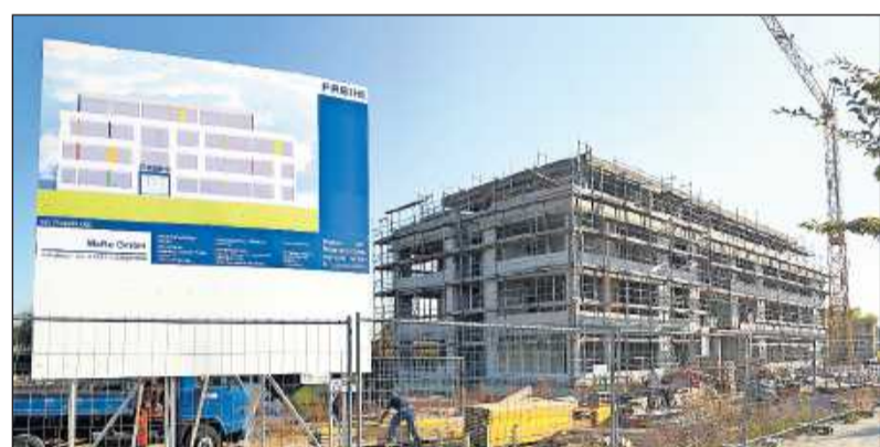
So sieht es derzeit auf der Baustelle aus. Entstehen sollen 2400 Quadratmeter Bürofläche. FOTO: FASIHI/FR/REI
